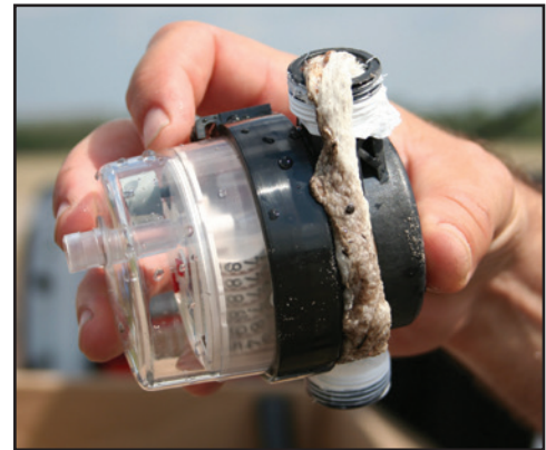
Figura 6. Limo filamentoso de azufre que tapa completamente un pequeño medidor de agua.
